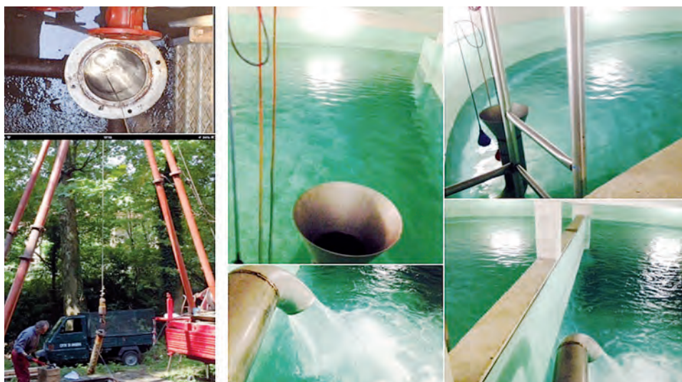
Pozzo 2: in alto a sinistra, il tubo lucido e ben pulito del pozzo 2; la luce al centro è il riflesso dell'acqua a 38 metri di profondità. Sotto: alcuni momenti della trivellazione/pulizia. A destra, immagini del nuovo bacino di Taino con il tubo di portata che eroga attualmente circa 18 litri/secondo (contro i 12 dei mesi estivi). Si noti dal segno sulle pareti della vasca il notevole abbassamento del livello nel mese di agosto.
